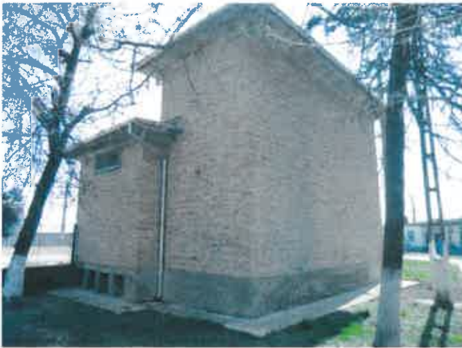
Fn2 Post trafo
