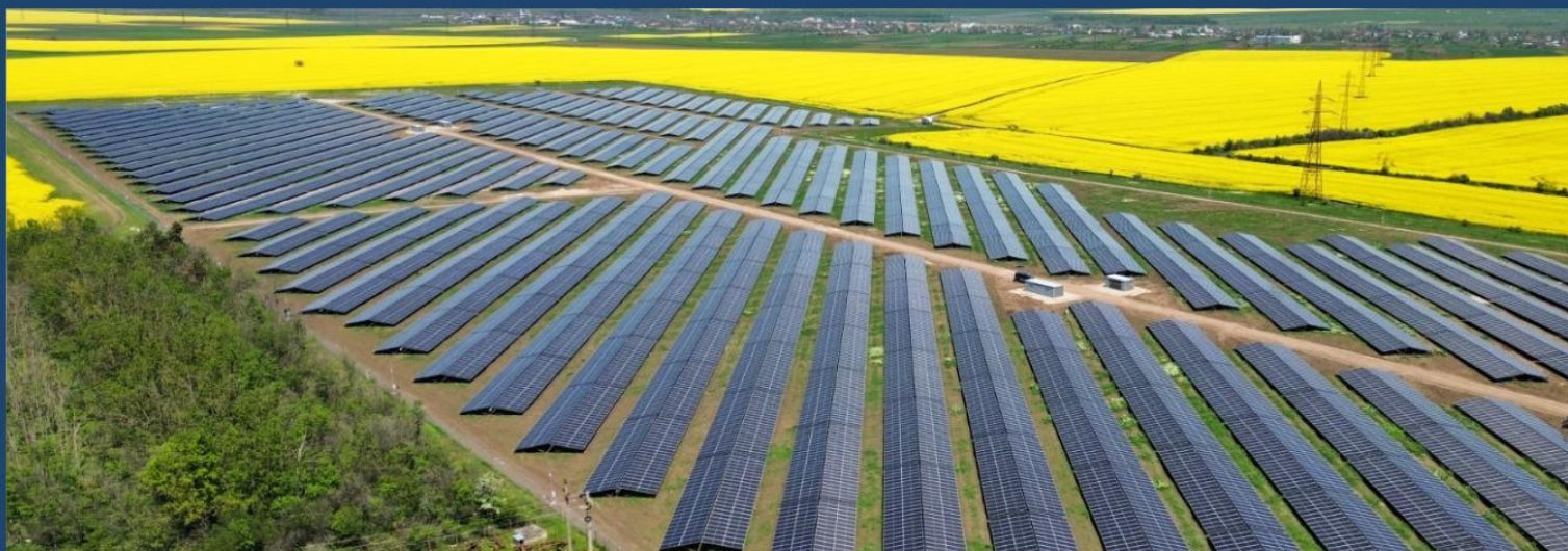
Parcul fotovoltaic Da Vinci de 26 MW al Premier Energy, cu o capacitate de stocare în baterii de 10 MWh, situat în Nanov, județul Teleorman, România.
