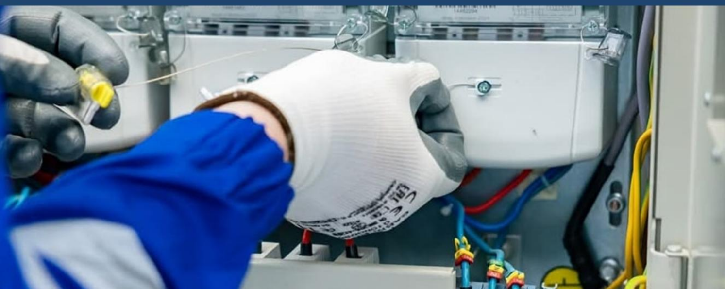
Instalare de contoare inteligente Premier Energy în Republica Moldova.
