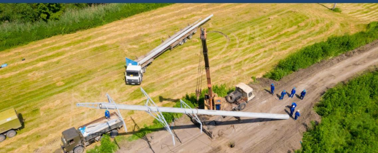
Linia electrică aeriană (LEA) de 110 kV CET-2 a Premier Energy, stația Codru, Chișinău, Republica Moldova.
