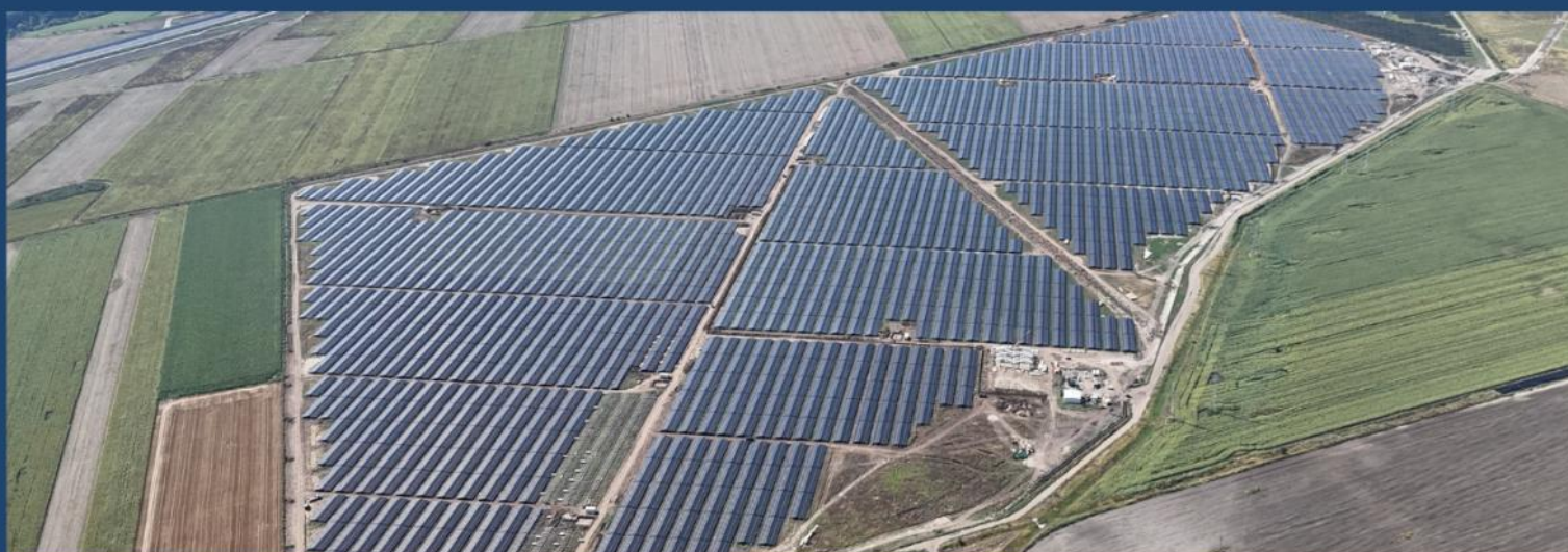
Proiectul fotovoltaic de 48 MW al Premier Energy, cu o capacitate de stocare în baterii de 16 MWh, situat în Stâlpu, județul Buzău, România.
